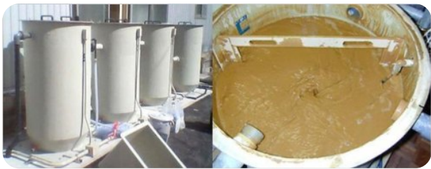
运行中的生物反应器情形
